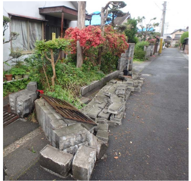
熊本地震によるブロック塀の倒壊
